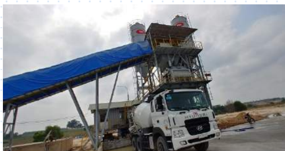
Hình ảnh trạm bê tông Bàu Bàng đang trong quá trình sản xuất.
